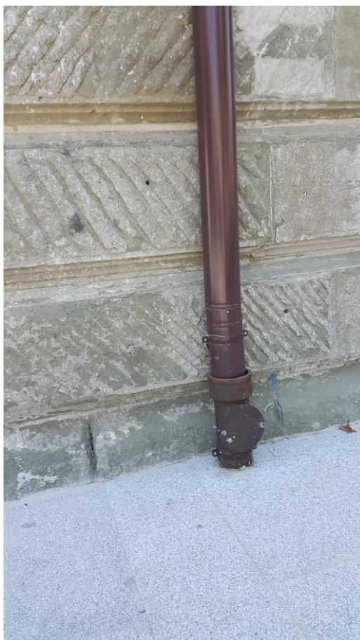
Фото 3. Отвод дождевой и талой воды с кровли непосредственно в городскую систему водостоков.
